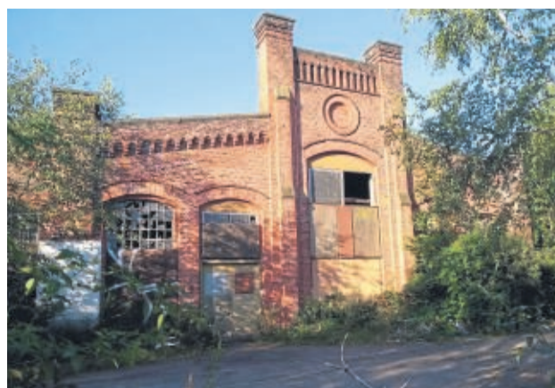
Wegen Einsturzgefahr gesperrt: Nur Eingeweihte finden den Weg zu dem Backsteinhallen-Komplex im Niemandsland des Kasseler Gleisdreiecks.
